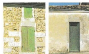
Ces moellons doivent être recouverts d'enduit.
